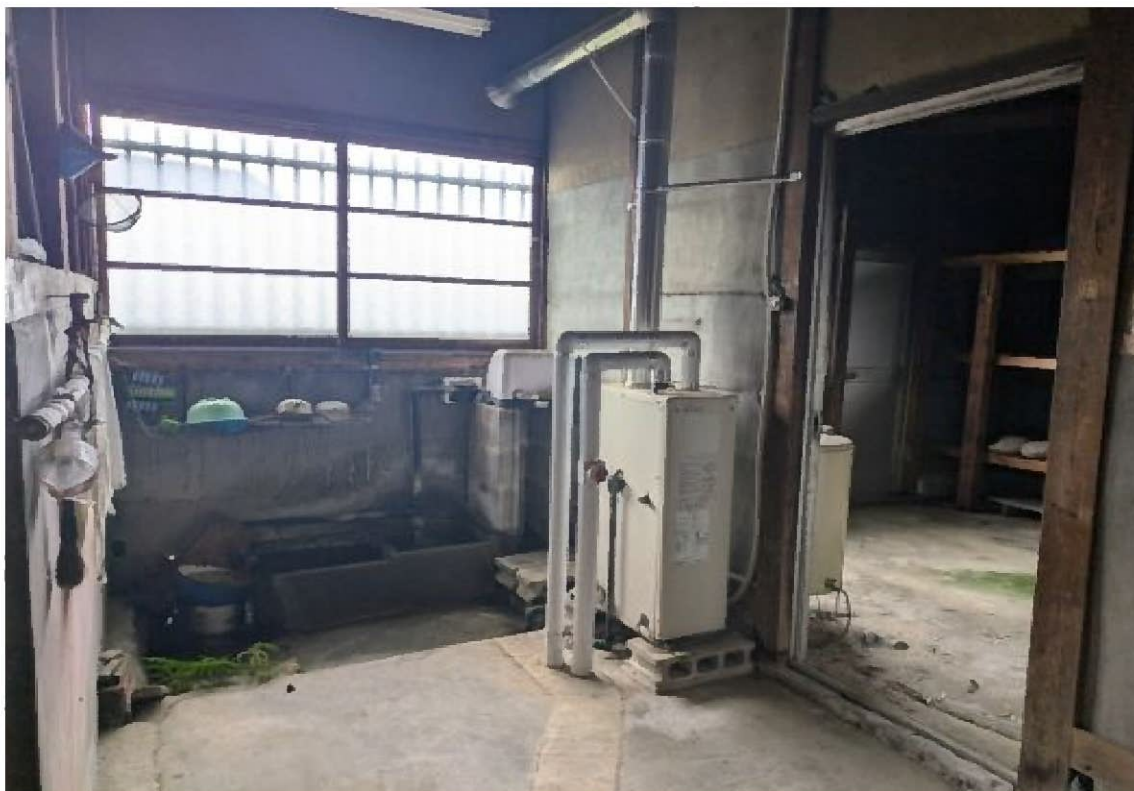
1 階土間 井戸船 石油給湯器
