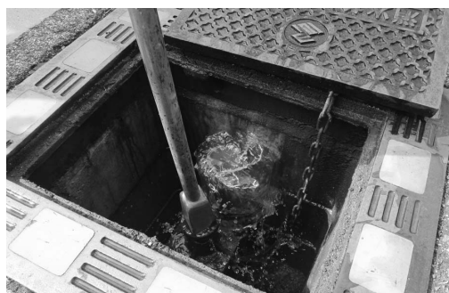
使用中の消火栓
