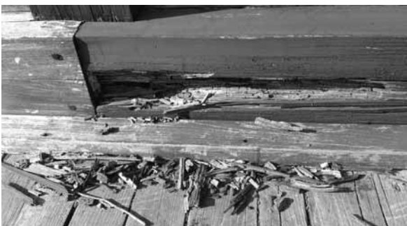
腐食が進む公園内の橋
